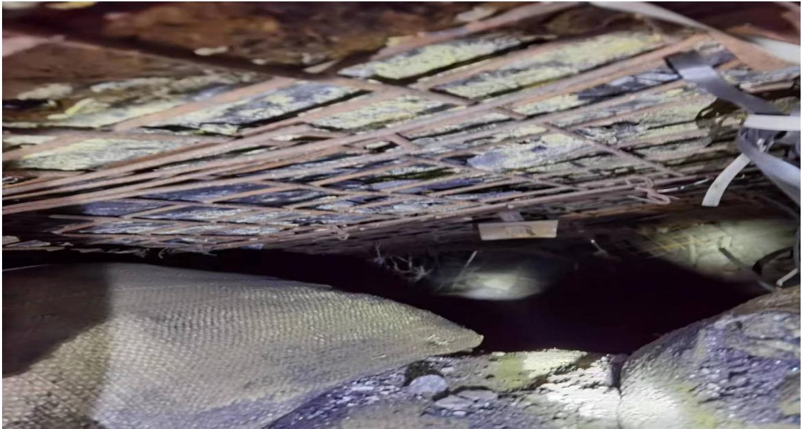
图9 事故现场照片（假矸石砌、假密闭）
